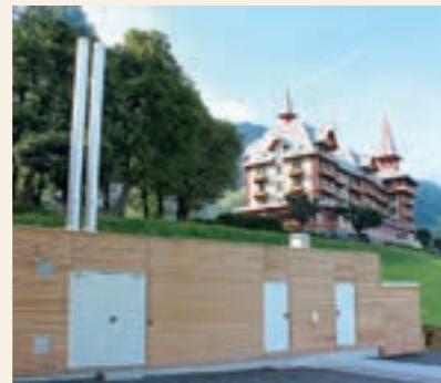
Hotel Paxmontana Flüeli-Ranft OW 2 x 200 kW Schnitzelheizung, Heizcontainer
