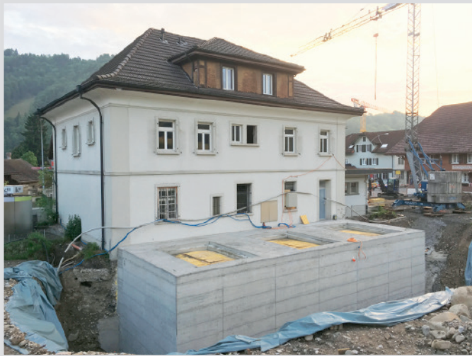
Le silo à bois déchiqueté est apposé au bâtiment.
