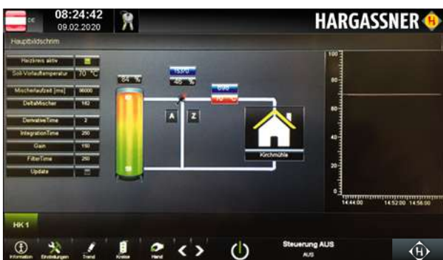
Regelung externer Gebäude
