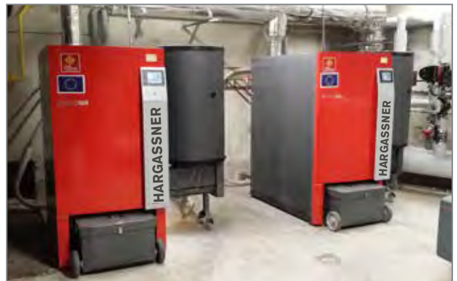
Chaudières EcoPK 2x110 kW avec deux extracteurs de type RAS
