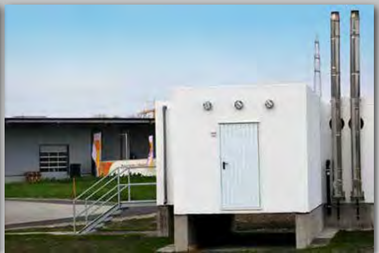
Deux containers simples utilisés comme chaufferie et silo de stockage pour une petite entreprise.
