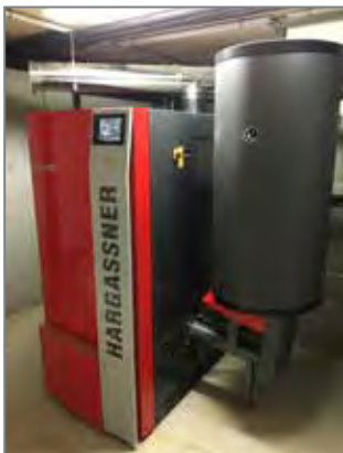
Chaudière EcoPK 70 kW avec silo RAPS
