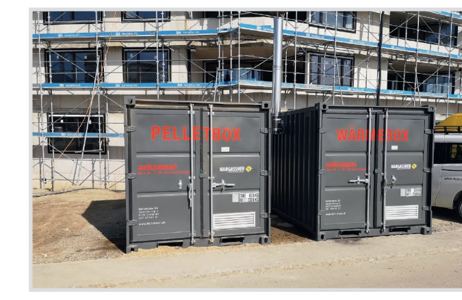
Energie-Box avec container à pellets installée sur un chantier et destinée au séchage d'un bâtiment.
