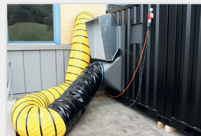
Vue arrière de l'Energie-Box: buses d'aspiration et de soufflage de l'air chaud
