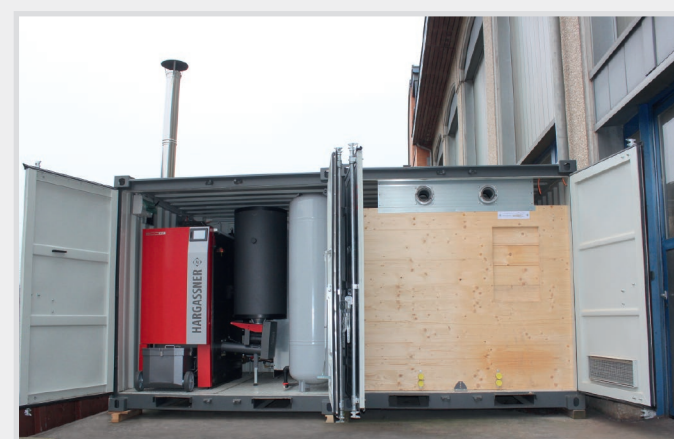
Vue intérieure du container: le silo à pellets, à d., et la chaudière à pellets, à g.
