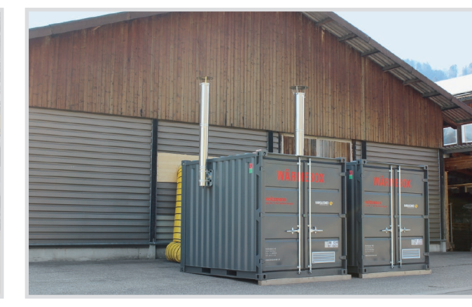
Ce hall de stockage est chauffé à l'aide de deux Energie-Box. Le silo à pellets est installé dans le hall.
