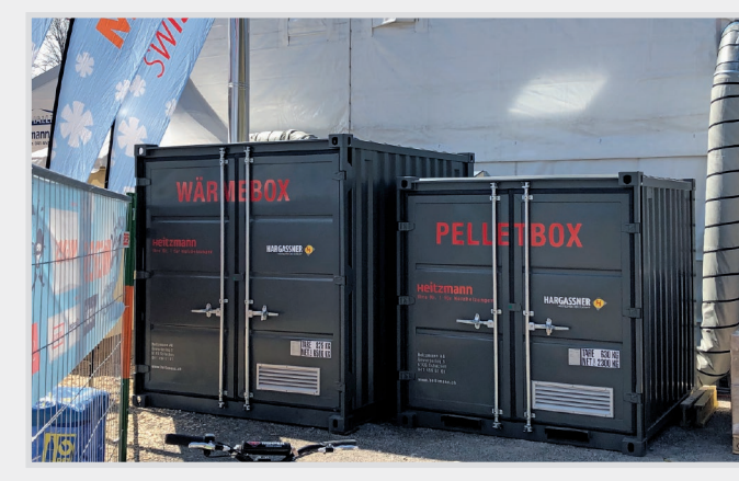
Cette Energie-Box permet de chauffer une tente événementielle. La chaudière se trouve dans un container de 10 pieds, les pellets dans un container de 8 pieds.
