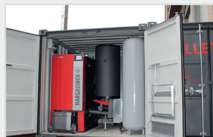
Container Energie-Box avec chaudière à pellets ECO-PK 120
