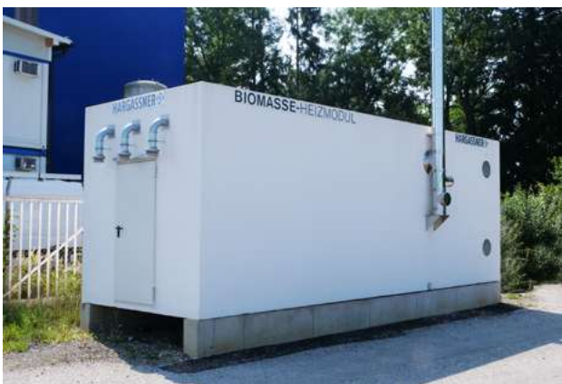
Einstock-Heizmodul 120 kW Pellets, Gewerbeobjekt
