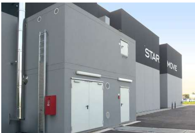
Doppelstock-Heizmodul 200 kW Hackgut, Gewerbe
