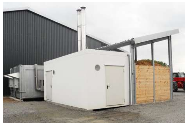
Einstock-Heizmodul 2 x 100 kW Hackgut, Gewerbe
