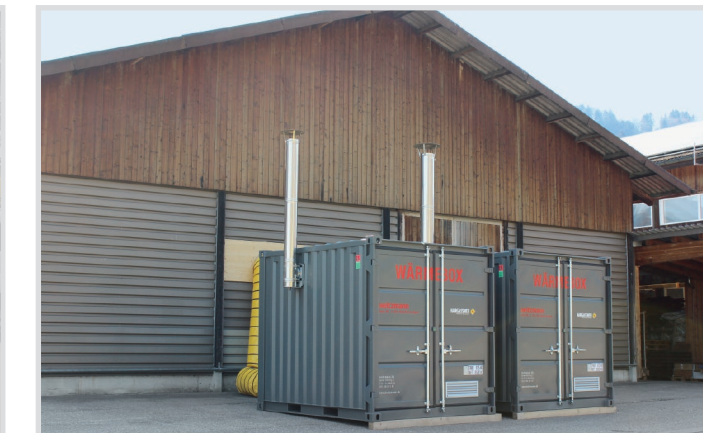
Mit zwei Wärme-Boxen wird diese Lagerhalle beheizt. Das Pelletlager ist in der Halle platziert.
