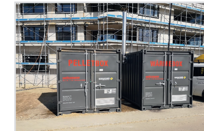
Wärme-Box mit einer Pellet-Box auf der Baustelle installiert für die Bauaustrocknung.
