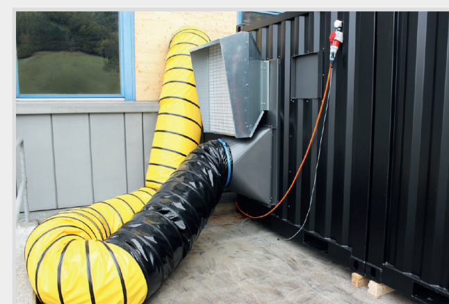
Wärme-Box von hinten: Luftansaug- und Ausblasstutzen
