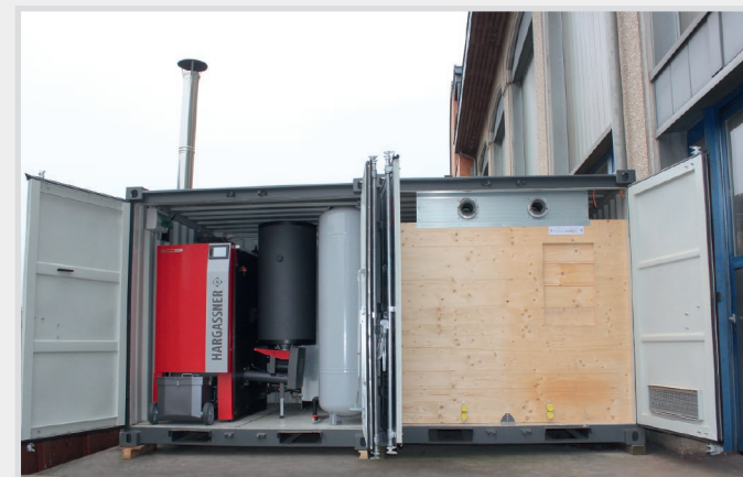
Blick in das Innere der Container: Pelletlager rechts und Pelletheizung links
