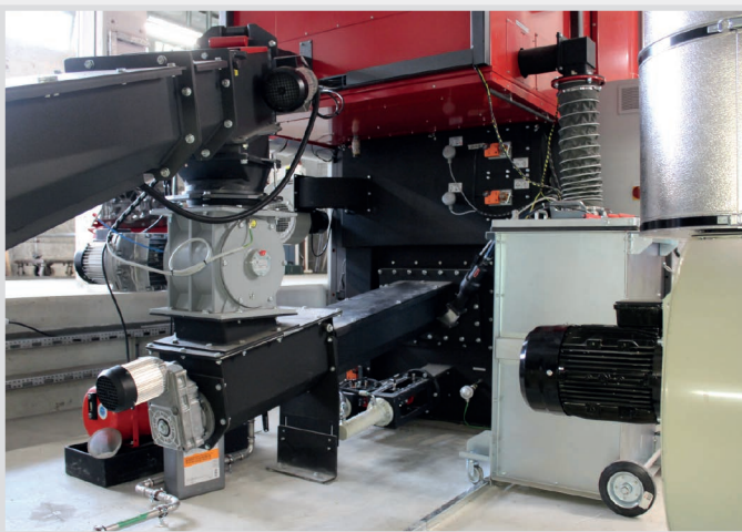
L' écluse à roue cellulaire assure une protection intégrale contre le retour de flamme . Les vis d'alimentation situées après l'écluse à roue cellulaire assurent un acheminement continu du bois déchiqueté vers la chaudière.
