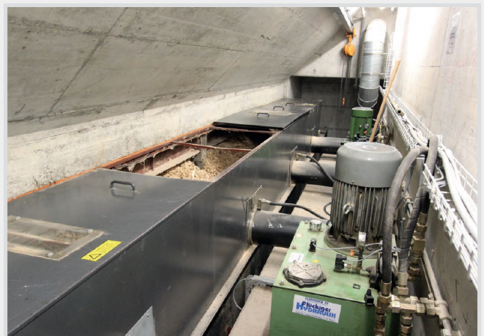
Der Hydraulikraum – das Herzstück der Schubboden-austragung – mit Hydraulikaggregat, Hydraulikzylinder und Querförderschnecke.
