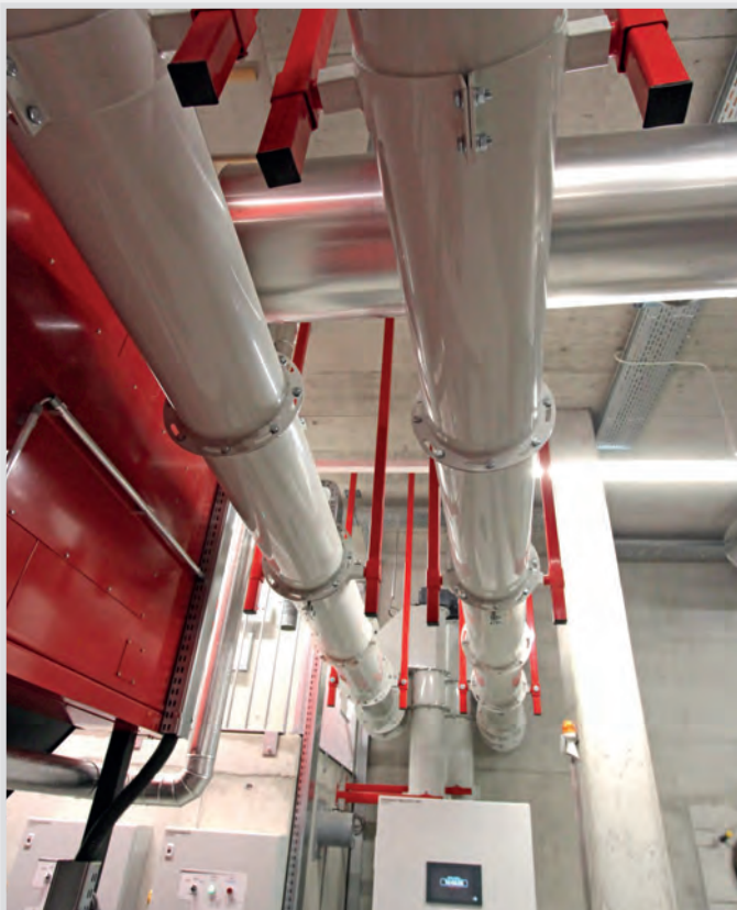
Senkrecht- und Waagrecht-Förderschnecken transportieren die Hackschnitzel aus dem Lager zu den Heizkesseln. Die grosszügig dimensionierten Schnecken mit einem Durchmesser von 300 Millimeter garantieren einen optimalen Betrieb.
