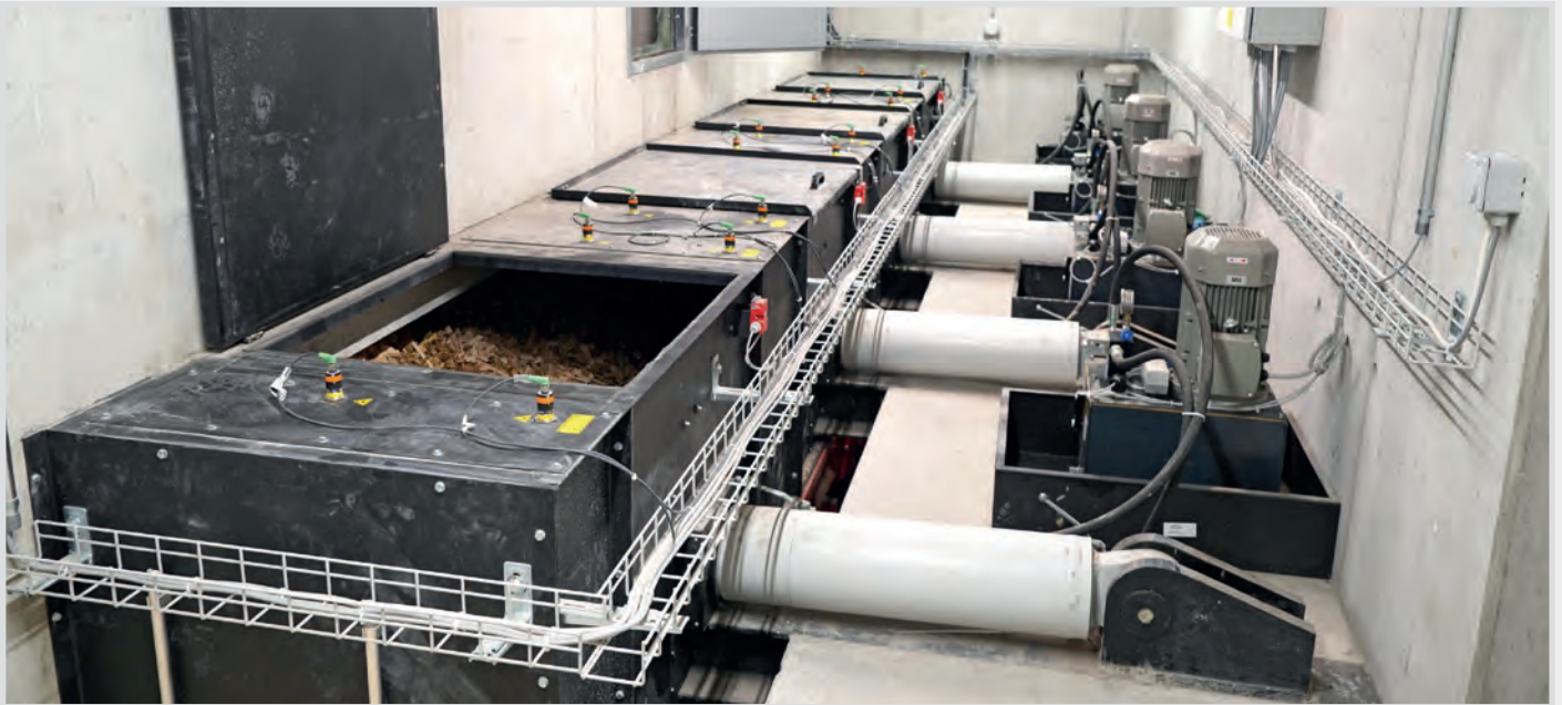
Der Hydraulikraum – das Herzstück der Schubbodenaustragung – mit Hydraulikaggregat, Hydraulikzylinder und Querförderschnecke. Die Abdeckung ergibt einen Schutz für Servicegänge, damit die Anlage den höchsten Sicherheitsanforderungen entspricht.
